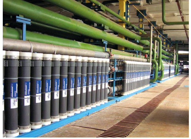
Resim 3. Ultra Filtrasyon ile Şehir Suyu Filtrasyonu
