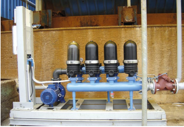
Resim 5. Soğutma Kulesi Havuz Suyunun AKM Değerini Düşüren Diskli Filtre ile Yapılmış Böbrek Filtre
