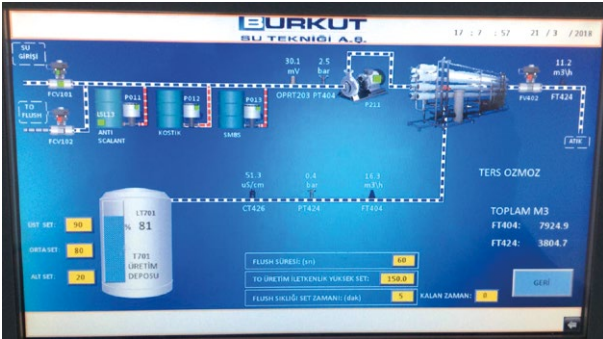
Su Sıfırlama Sisteminin PLC Kontrol Panosu
