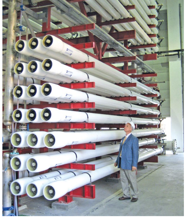
Deniz Suyundan Şehir Suyu Üreten Ters Ozmoz Sistemi
