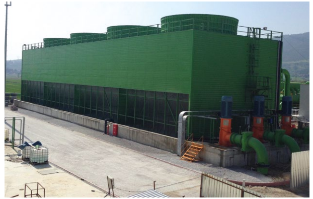
Resim 2. Su Soğutma Kulesi
