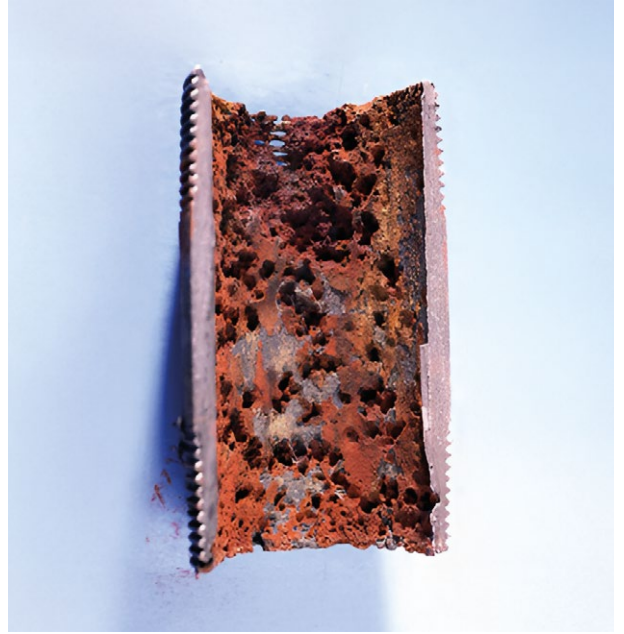
Resim 3. Aç Su Sebebi ile Korozyona Uğramış Borunun İçi
