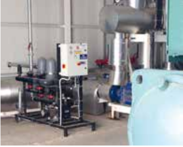
Resim 4. Chiller Eşanjörü Koruyucu Servis Hattı Filtresi
