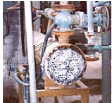
Resim 1. Tıkanmış Borulu Eşanjör
