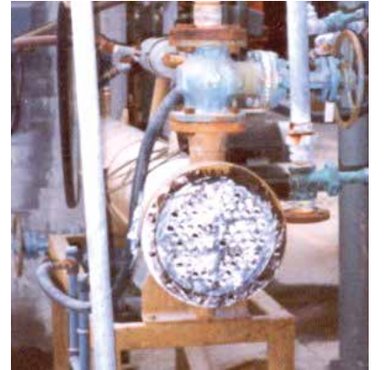
Resim 2. Kireç ile tıkanmış Borulu Eşanjör
