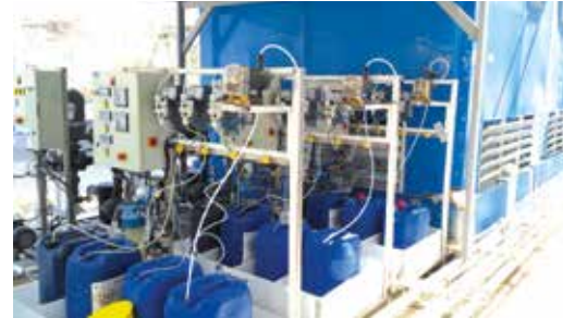
Resim 7. Eşanjör Koruyucu Soğutma Suyu Böbrek Filtresi ve Kimyasal Dozaj Sistemi
