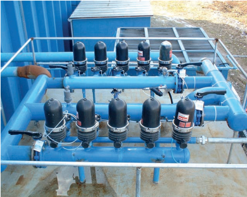
Soğutma Suyu için Diskli Filtre
