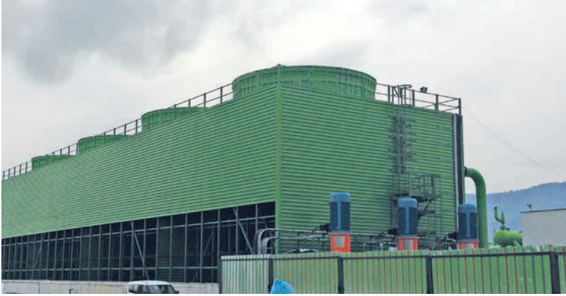
Su Soğutma Kulesi
