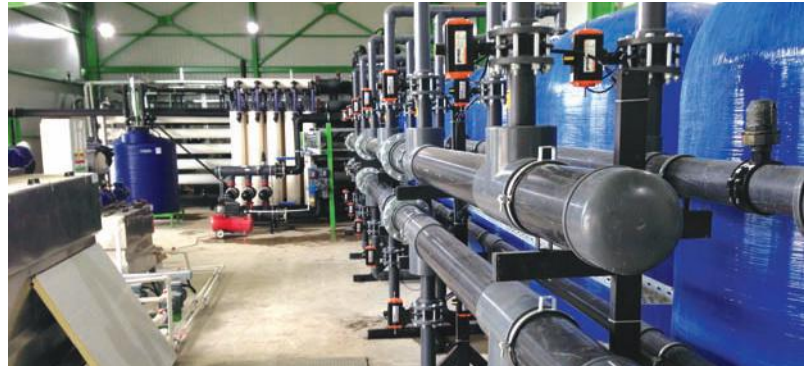
Resim 5. Özel dolgu filtre, ultra filtrasyon ve ters ozmoz sisteminden oluşan ve her aşamada suyun kalitesini ölçen kaliteli proses suyu hazırlama sistemi.
