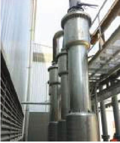
Resim 1. Soğutma sularının katı ayırıcılar ile filtrasyonu
