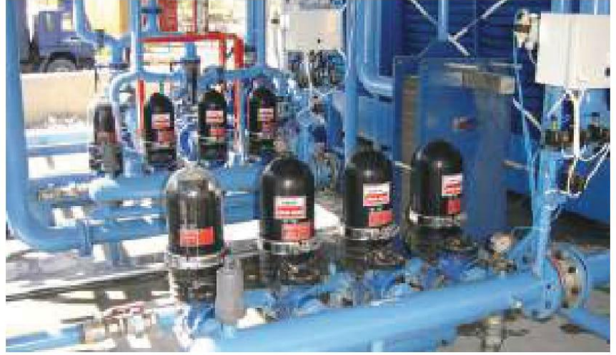
Resim 2. Soğutma sularının disk filtreler ile filtrasyonu
