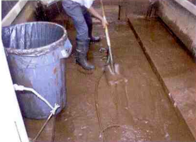
Resim 2: Soğutma kulesi dibinde toplanan katılar
