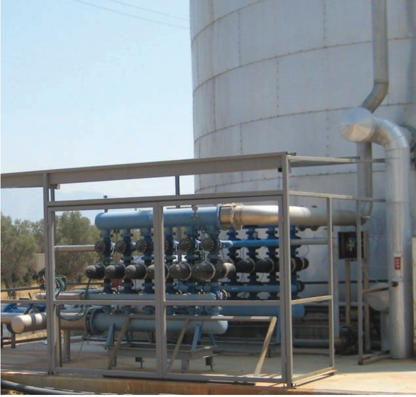
Depo Öncesi Kuyu Suyu Filtresi
