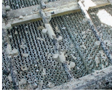
Resim 4. Soğutma Kulesinde Oluşan Katılar
