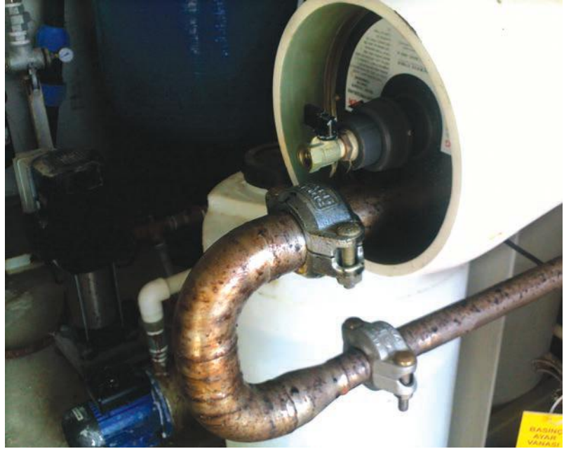
Resim 3: Paslanmaz Çelikte Klor Korozyonu
