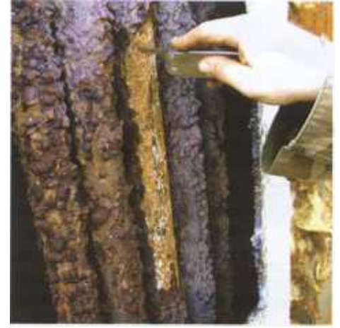
Borulu ısı eşanjöründe korozyon
