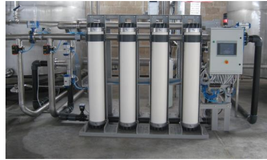
Resim 5. Ultra Filtrasyon Sistemi
