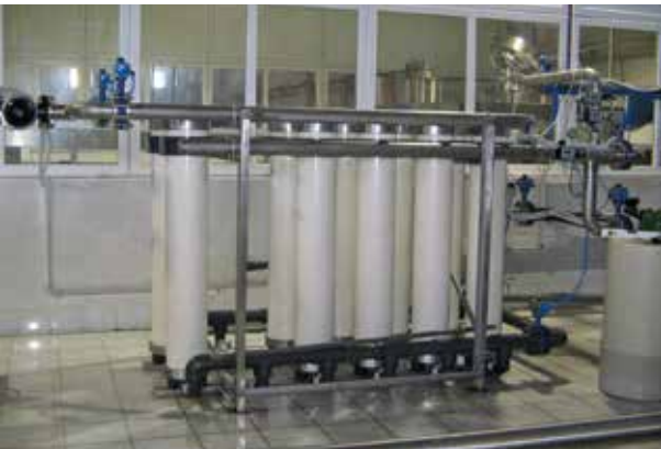
Resim 2. Şişe Suyu Dolum Tesisinde UF Sistemi
