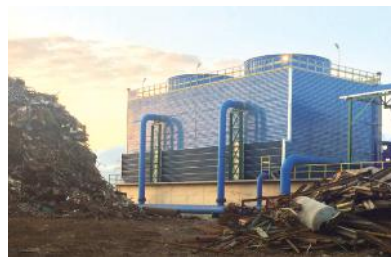
Tozlu Ortamda Çalışan Su Soğutma Kulesi
